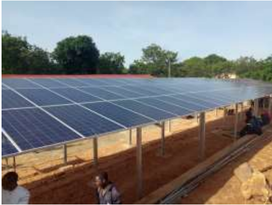
Nelle scuole tecniche Don Bosco del Kenya, non manca il laboratorio per l'apprendimento di installazione di pannelli solari.
